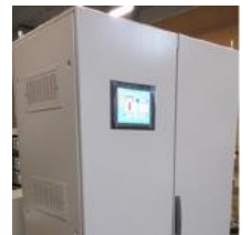
医療機関向け 非常用水素燃料電池
